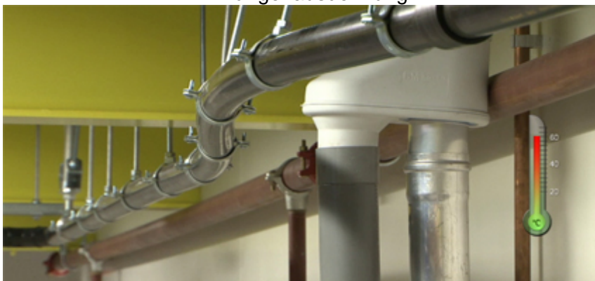
Bild 2: Rohr bei starker Längenausdehnung
