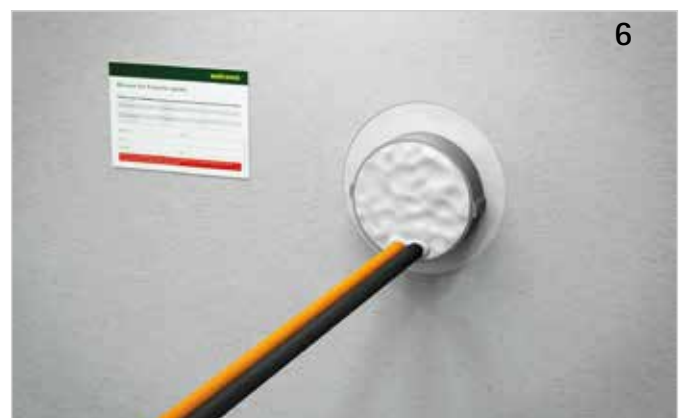
Wenn erforderlich bzw. vorgeschrieben Schott kennzeichnen.
