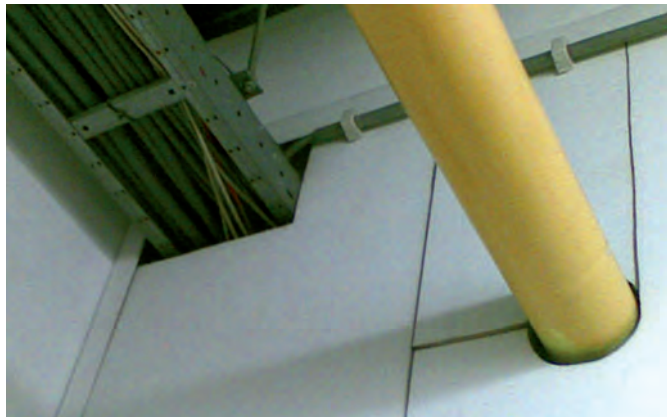
Elektrotechnische installatie / Gas
