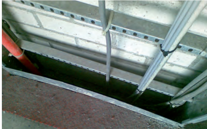
Elektrotechnische installaties / Communicatietechniek
