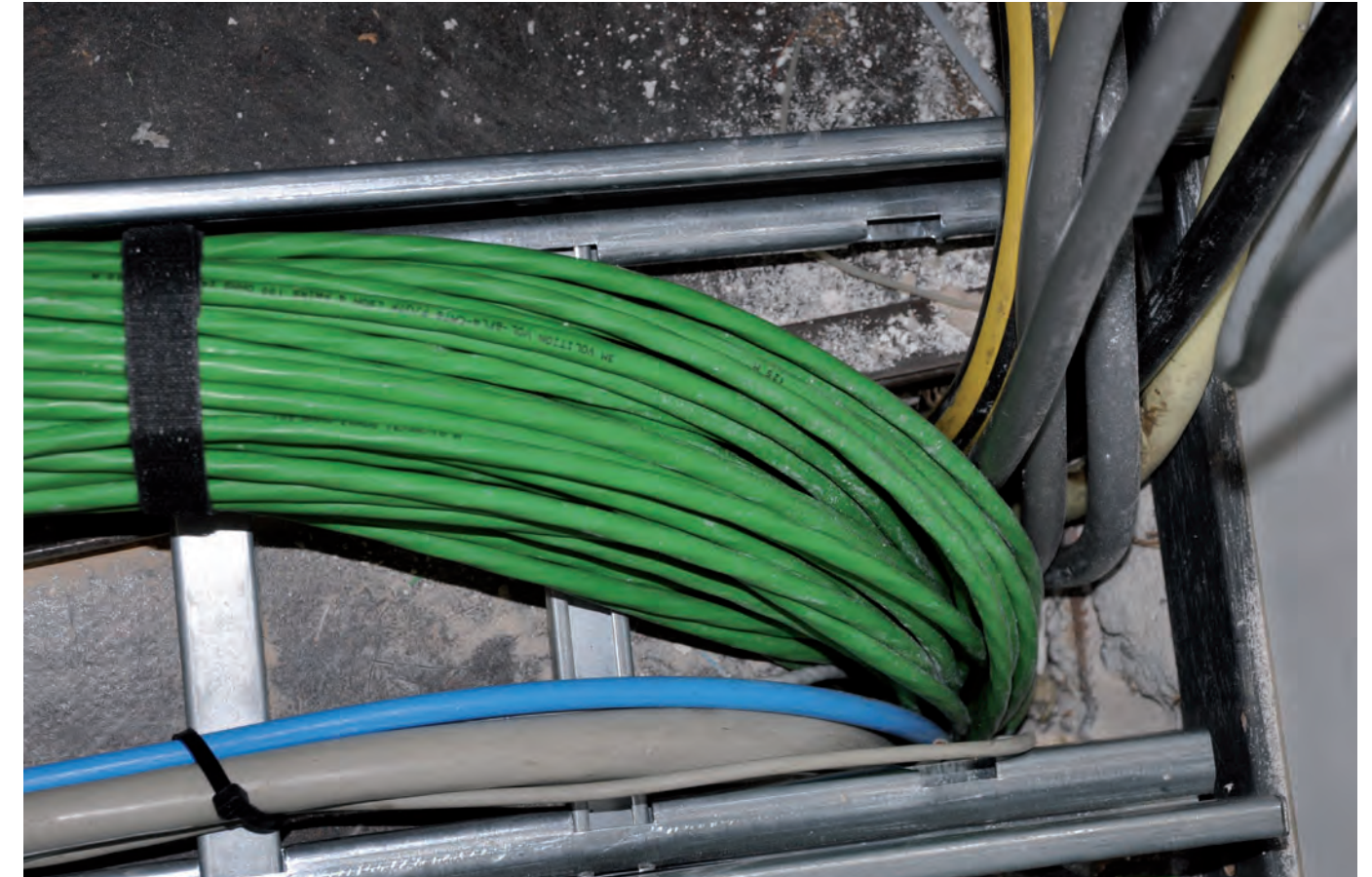
Kabels, wel of niet ondersteund door kabelgoten (-ladders) lopen door muren en vloeren
