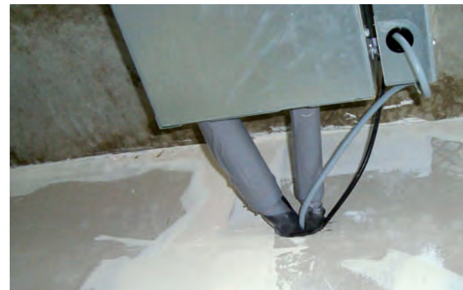
Elektrotechnische installaties / Communicatietechniek
