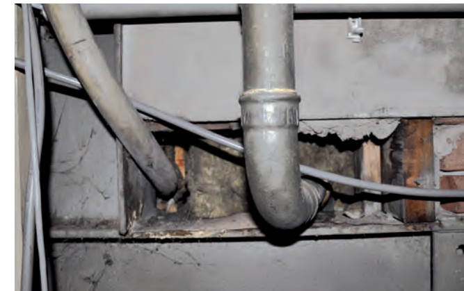
Sparing / Elektrotechnische installatie / Gas / Perslucht
