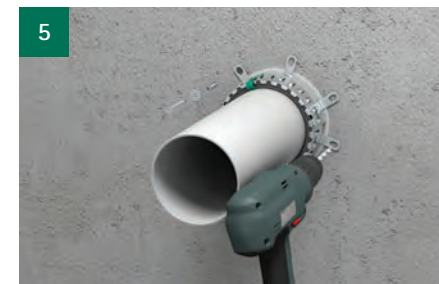
Boren (de bevestigingslippen mogen eventueel ook 90° omgebogen en ingemetseld worden in de brandwerende mortel!).
