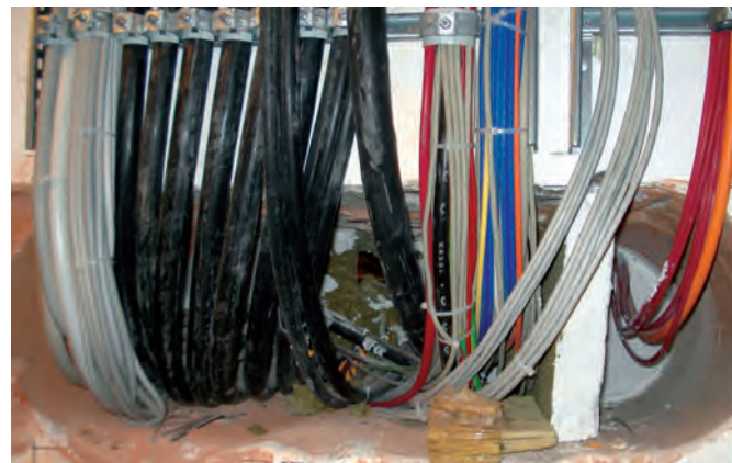
Elektrotechnische installaties / Communicatietechniek
