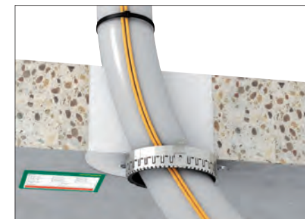
Buizenpostsysteem met 2 kabels.
