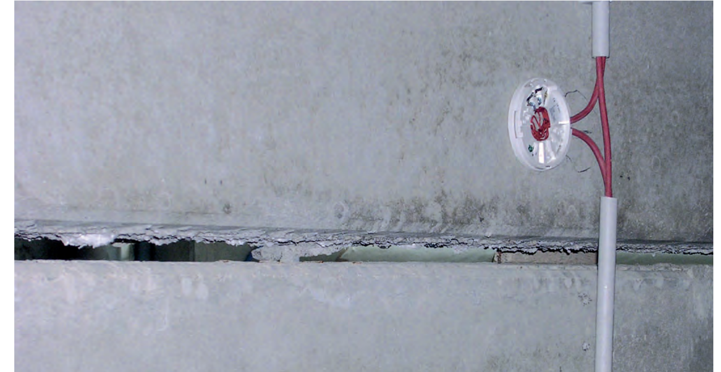
Voegen en naden, maar ook grotere sparingen dienen 100% brand- en rookdicht te zijn
