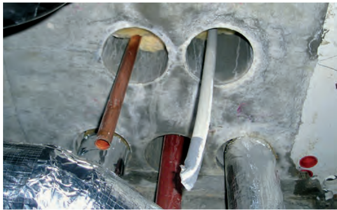
Drinkwater / Centrale verwarming
