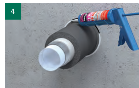
Resterende opening rookdicht afwerken (bijv. met Tangit FP 430 Brandwerende Acrylaat Kit of met Pacifyre® FPM Brandwerende Mortel).
