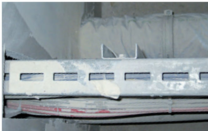
Elektrotechnische installaties / Communicatietechniek
