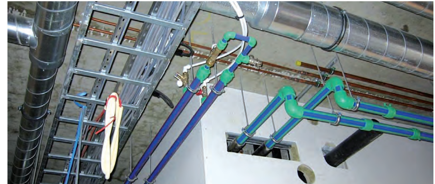
Een variëteit aan typen buis- en kabel(goot)doorvoeringen is eerder regel dan uitzondering
