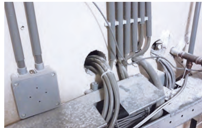
Elektrotechnische installaties / Communicatietechniek
