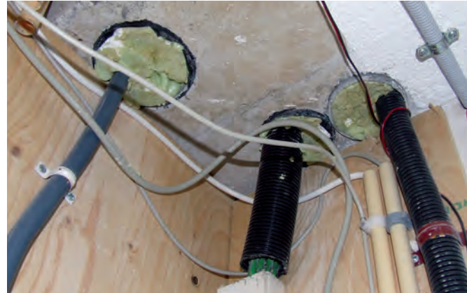
Elektrotechnische installaties / Communicatietechniek
