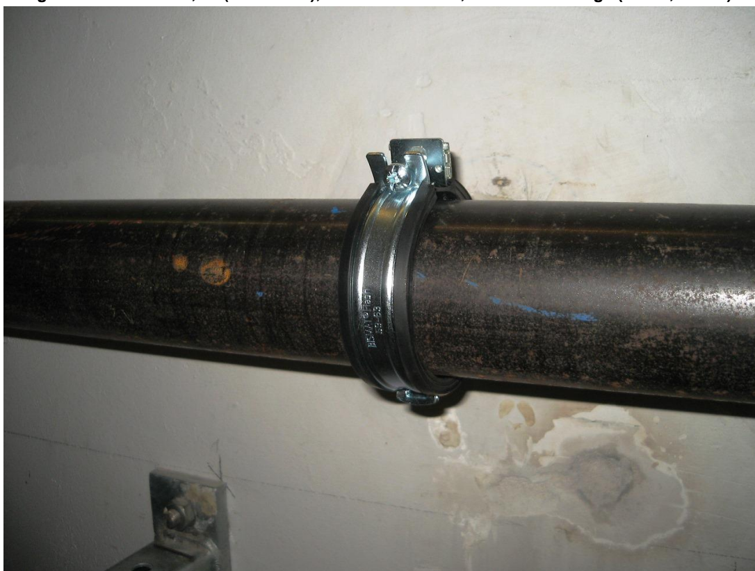
Bild 2: Messung 3: BISMAT® Flash, 2" (59 - 63mm), Anschluss M8/10, mit EPDM-Einlage (20 x 4,20 mm)
