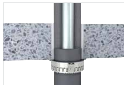
Nehořlavé potrubí s protipožární manžetou na spodní straně stropu.
