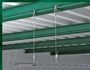
Chemins de câble
